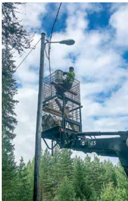
Valaisimien vaihdon yhteydessä kärsittiin pahimpia valaistuksen tiellä olleita oksia.
